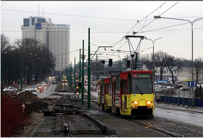
Organizacja ruchu zastosowana na odcinku jednotorowym ma duży potencjał. Na zdjęciu: cztery pociągi (15/6 288+287, 14/8 174+173, 10/14 704 i 10/6 553) przejeżdżają „ciągiem” w ramach jednego cyklu świateł.
