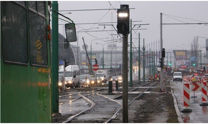
Rozjazd nakładkowy od strony dworca PKS.
