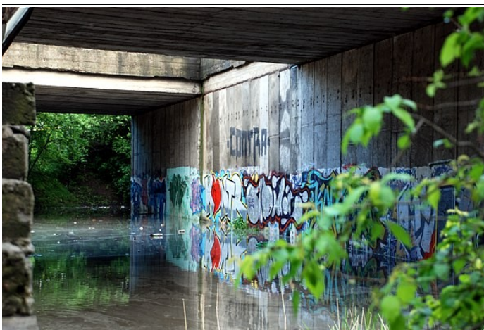
Niedoszły tunel tramwajowy za pętlą os. Lecha jest regularnie zalewany wodami opadowymi.
